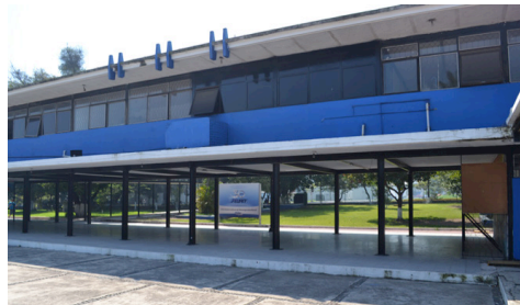
Fig. 3. Imagen reciente del Edificio de la Escuela Preparatoria. Sistema pilotis. Archivo personal
