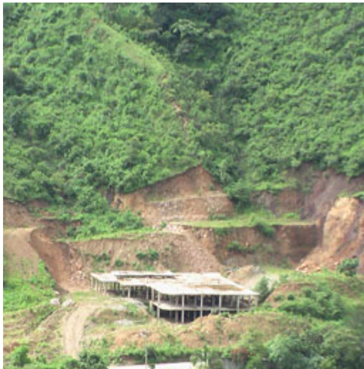
Figura 2.1: Paralización de la construcción de un hospital por su alto riesgo. Fuente: www.paho.org/desastres .
