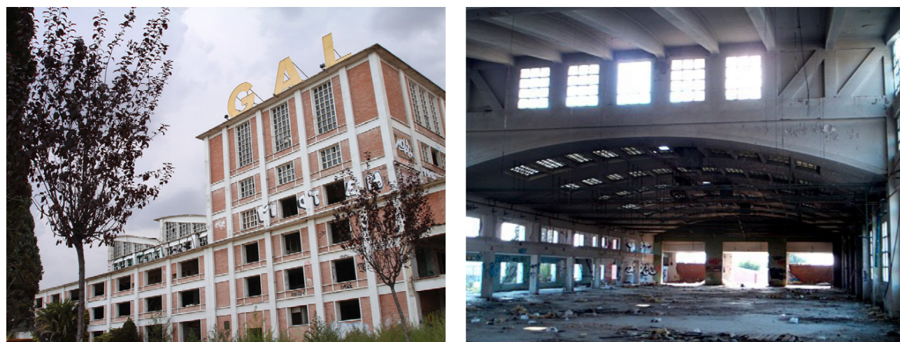
Fig. 231: Deterioro de la fábrica Gal, tanto en la envolvente exterior como en el interior de la nave de producción
