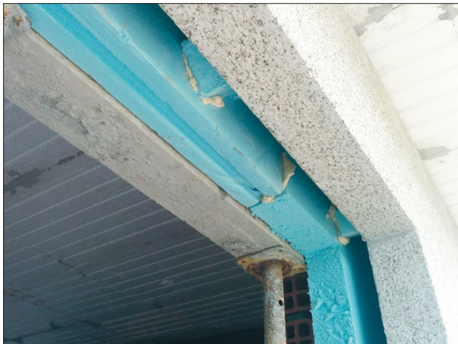
-Imagen K- Colocación de aislamiento de poliestireno extruido separado de la hoja exterior con distanciadores del mismo material (Foto: M. Rañó Rodríguez)
