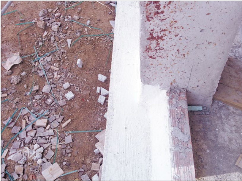
-Imagen J- Realización de una canaleta en la parte inferior de donde irá situada la cámara de aire de una fachada (Foto: M. Rañó Rodríguez)
