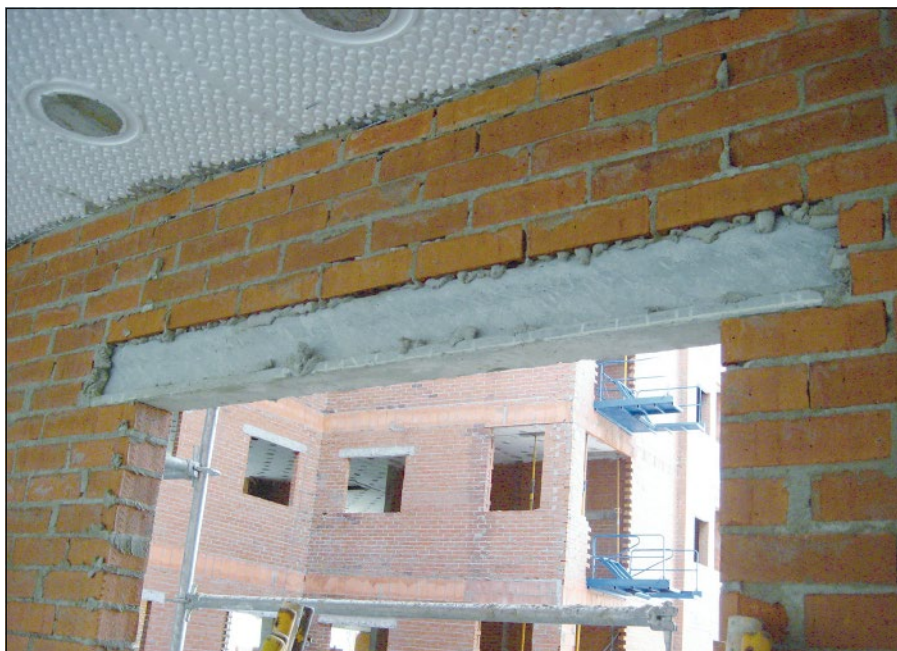
-Imagen G- Colocación de dintel en la hoja exterior de una fachada
