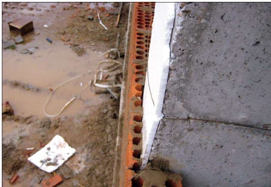
-Imagen F- Encuentro de la hoja exterior del cerramiento con un pilar, interponiendo un elemento independizador
