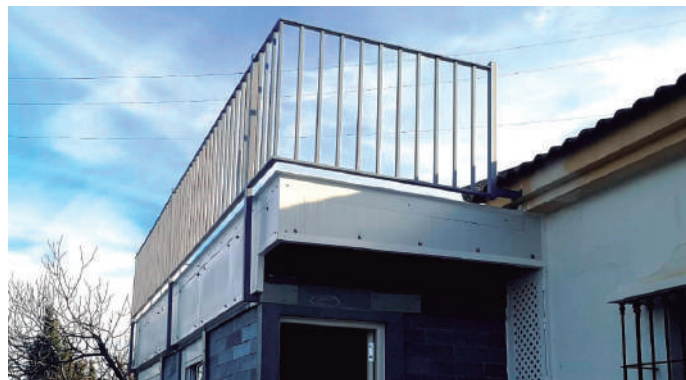
Imagen 15. Detalle peto perimetral a la cubierta de chapa metálica. Ronda, Málaga. Fuente: Llanos, Fernando. Creador del sistema Bloqueplas. 2019
