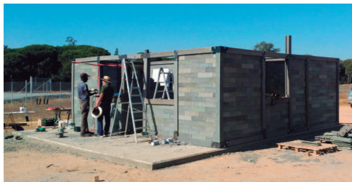
Imagen 4. Visita obra. Vivienda temporal para trabajadores agrícolas. Proceso constructivo. Lepe, Huelva. Fuente: elaboración propia
