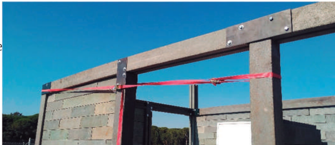
Imagen 6. Visita obra. Detalle del uso de un tensor auxiliar para el anclaje de la estructura. Lepe, Huelva. Fuente: elaboración propia
