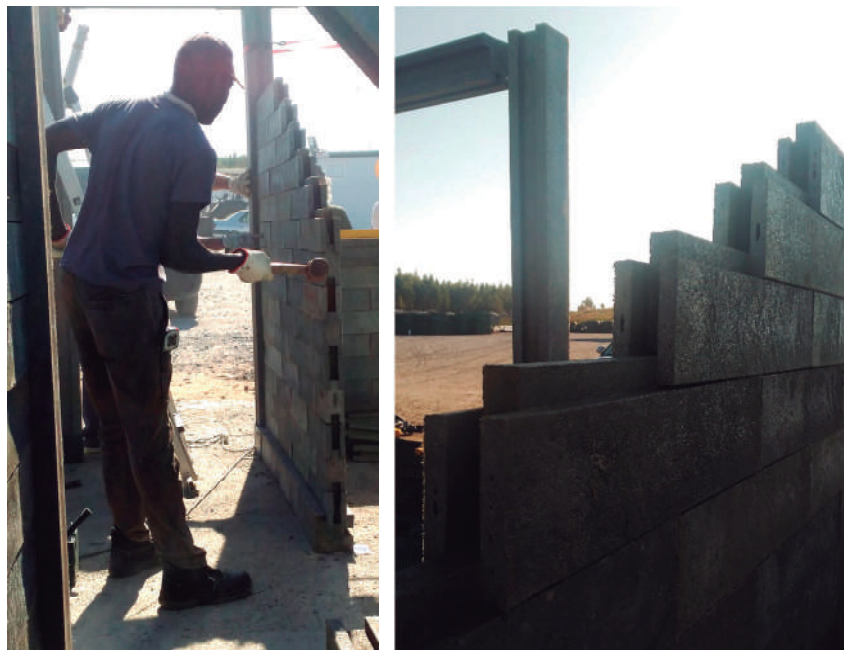
Imagen 5. Visita obra. Detalle colocación bloque – pilares. De izquierda a derecha: operario ejerciendo presión al muro contra la viga; detalle muro. Lepe, Huelva. Fuente: elaboración propia
