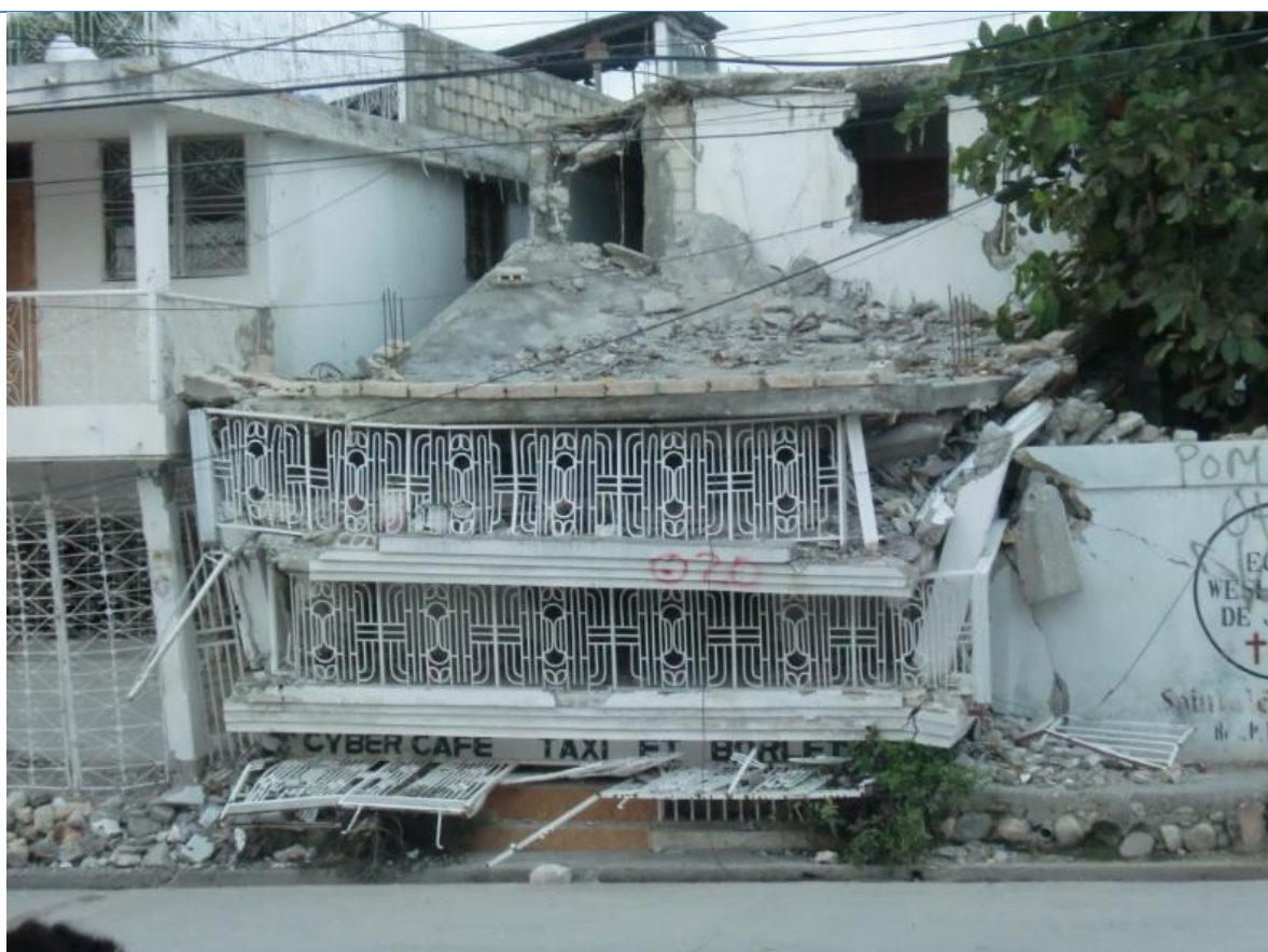
Foto 9: Vivienda arruinada por el terremoto de enero de 2010, Jacmel, Haití. Pérez C. (2010)
