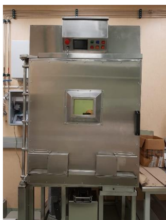
Figura 102: Cámara protectora del generador.
