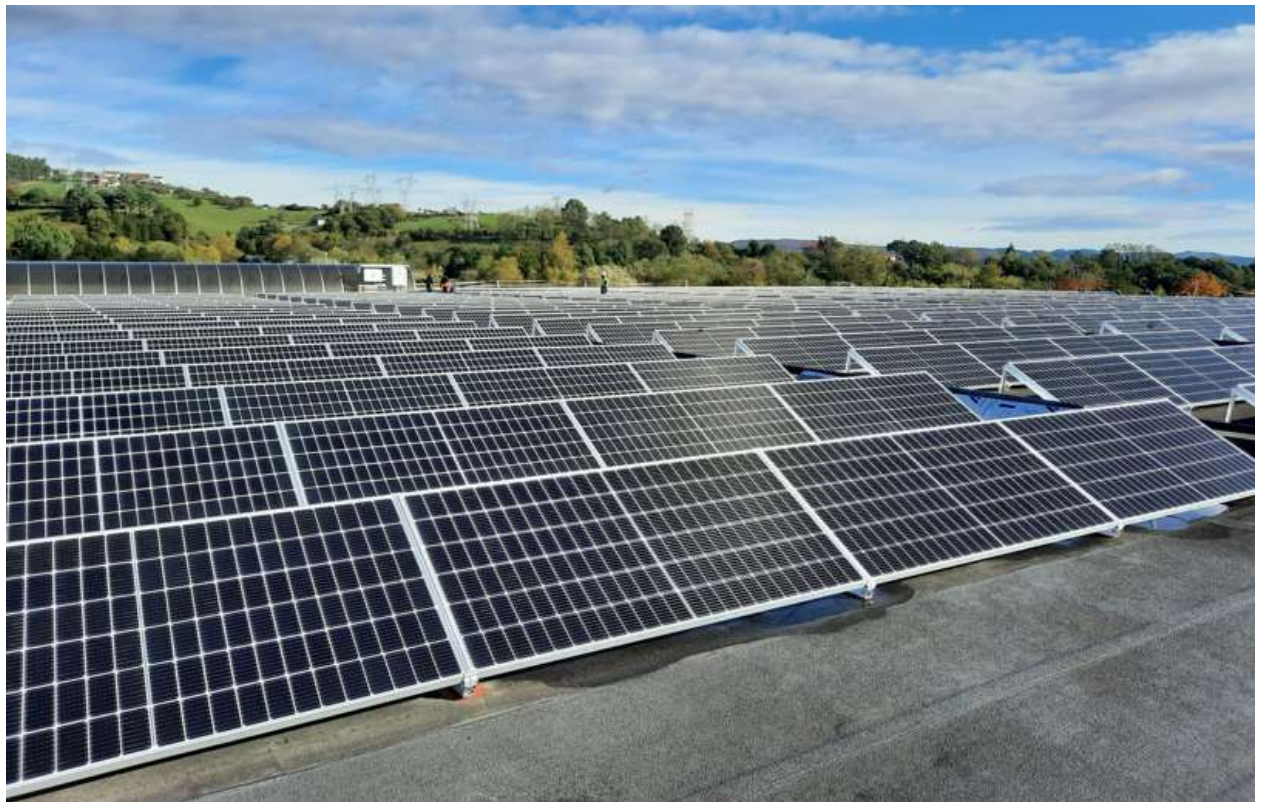
Figura 3. Campo solar instalado sobre la cubierta del depósito (Tomado de Agirregoikoa, 2021)
