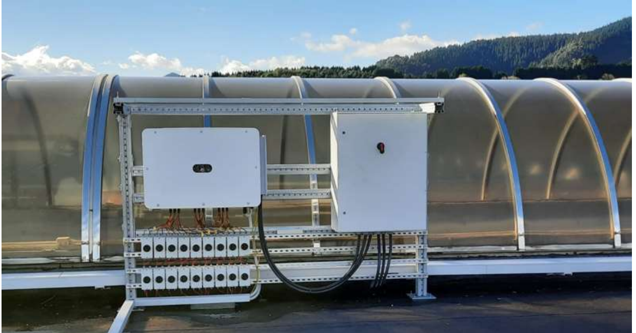
Figura 4. Inversor de la instalación fotovoltaica (Tomado de Agirregoikoa, 2021)
