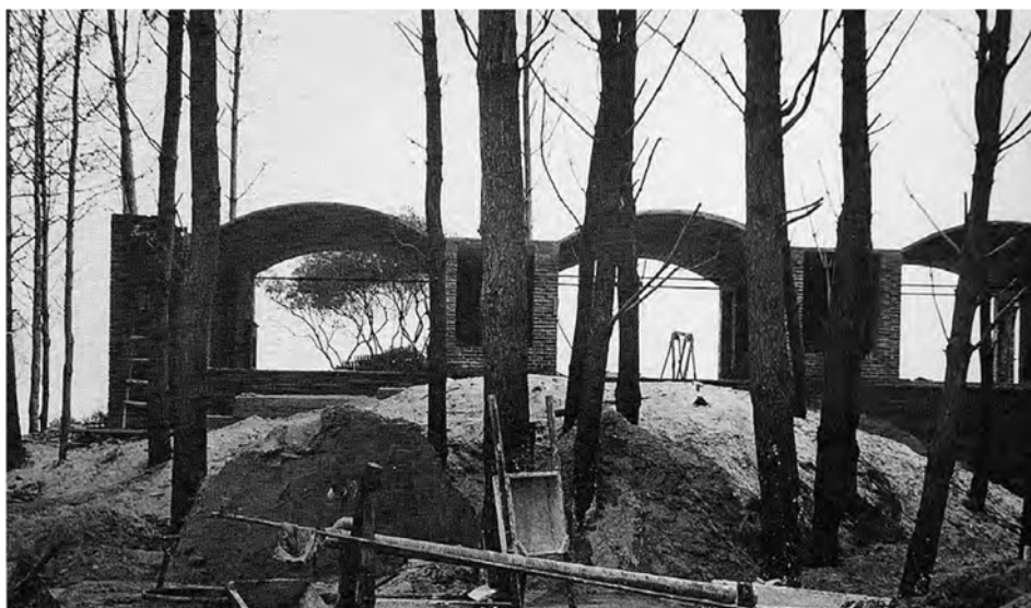
Imagen III.1.23. Casa Berlingieri en obras. Fotografía del Archivo Histórico del Colegio de Cataluña (Nudelman, 2013, p. 198).
