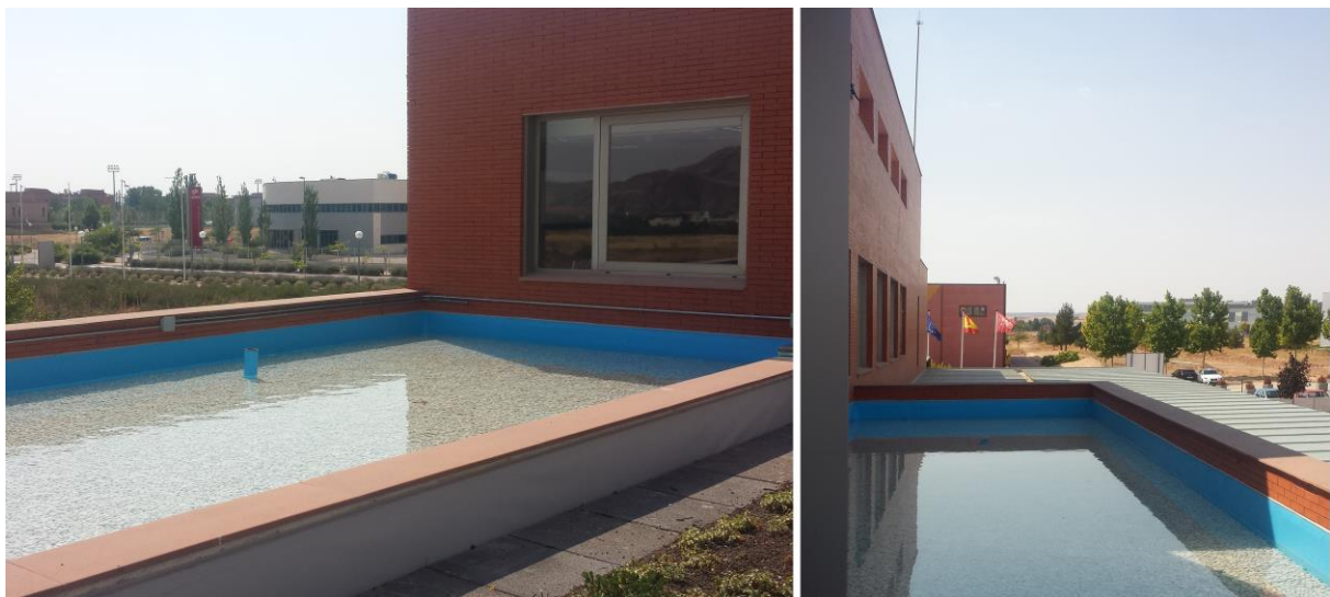
Figura 8: Aljibes superficiales en cubierta. Elaboración propia
