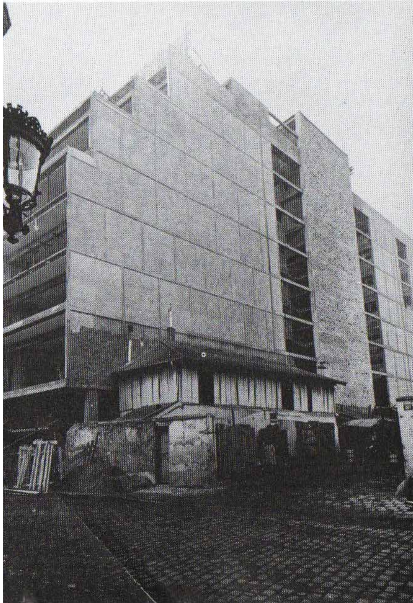
FACHADA NORTE DE LA CITÉ DE REFUGE durante su construcción. Se aprecian claramente tres pozos de luz. Imagen tomada de Taylor 1987, 90.
