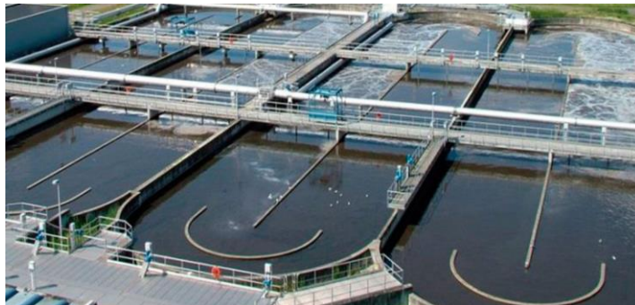
Fig.2 Reactor de digestión aeróbico
