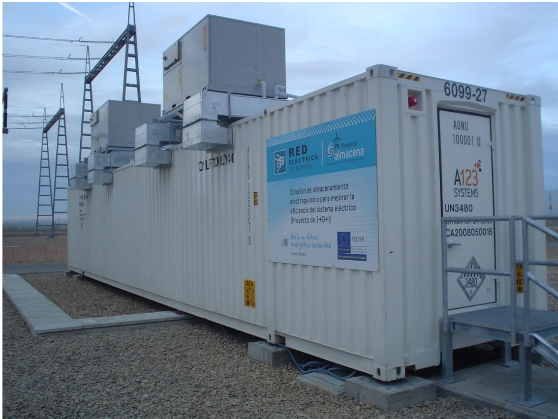
Figura 2.25: Batería de ión-litio instalada en la subestación de transporte de Carmona [21]
