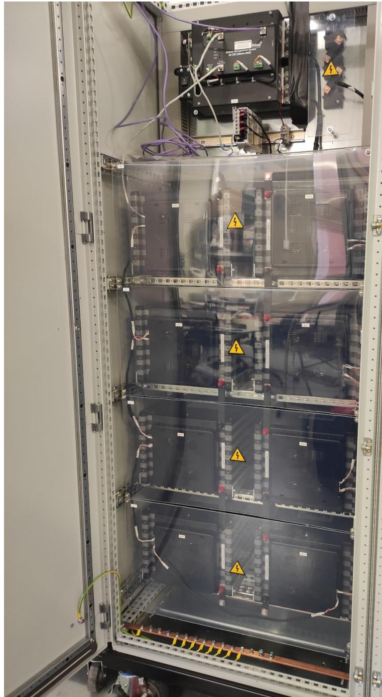
Figura 8.1: Baterías y BMS del laboratorio GEISER
