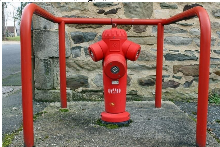
Figura 4-9: Imagen de boca de incendio. [27].
