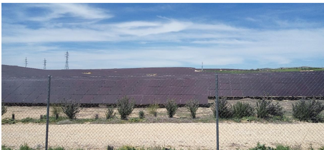
Fig. 25. PSF Saelices vista desde la entrada sur por el camino del cementerio (Fuente: Elaboración Propia)
