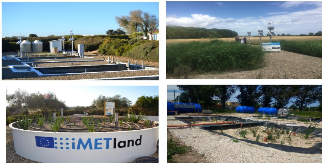
Figura 7. Aspecto real de distintos humedales construidos bioelectrogénicos en funcionamiento. Fuente: Proyecto iMETland.
