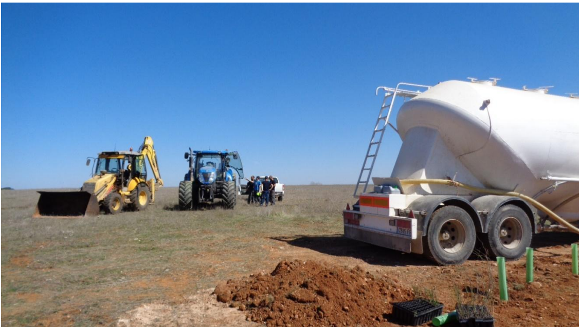
Figura A16. Maquinaria utilizada para la creación y llenado de la charca (retroexcavadora y cuba de agua en los extremos) y para la realización de los surcos de los setos (tractor en el centro)
