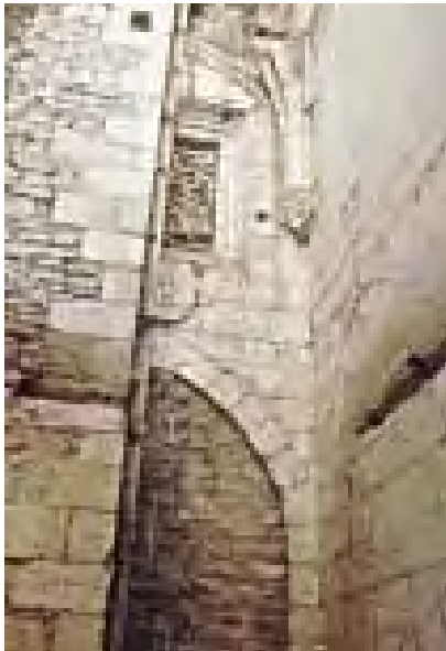
Imagen 439. Fondo sur de la amortizada capilla de Los Reyes, en el quinto tramo de la nave sur. Se aprecia el cegado de los vanos, el arranque de la demolida bóveda de terceletes y, a la izquierda, el gran machón de refuerzo del contrafuerte junto a la portada de Santa Ana, que se encuentra tras este muro del fondo
