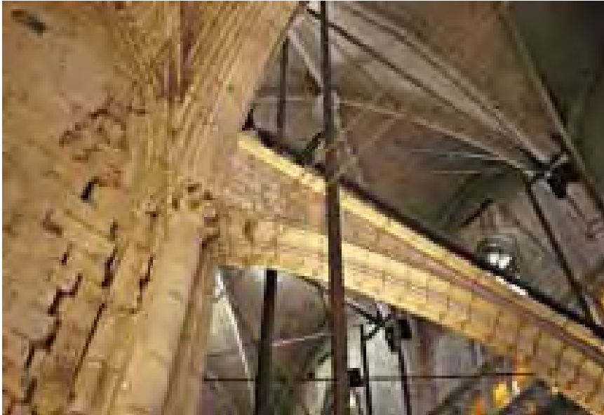
Imagen 438. Grieta producida en la pilastra de esquina entre el transepto y la nave norte por la apertura, en su muro de cierre, de la capilla de Santa Victoria
