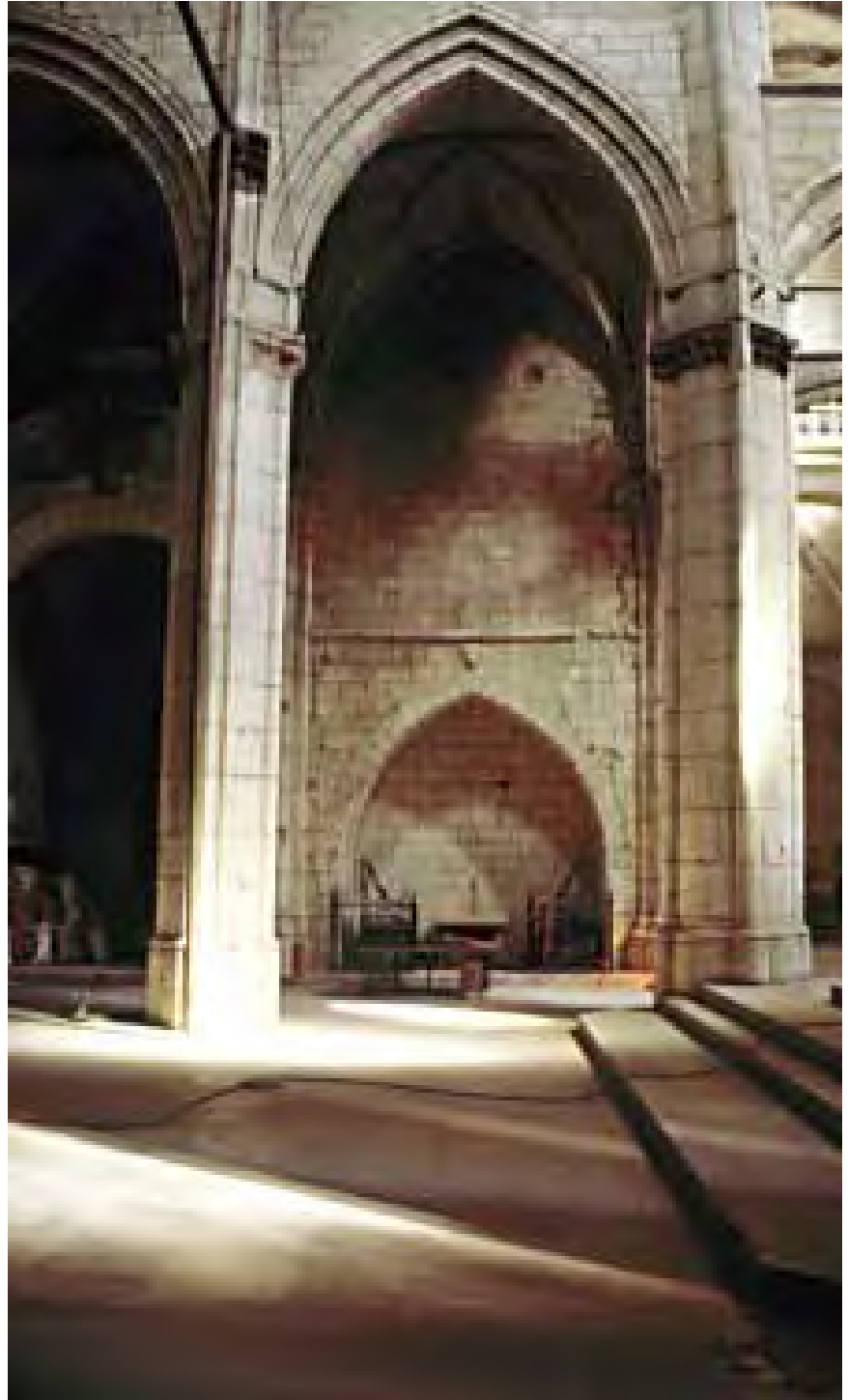
Imagen 492. Alzado interior del arco del quinto tramo de la nave central, con sus dos pilares inclinados hacia la derecha, donde se sitúa el crucero. Al fondo se ve la capilla de Santa Victoria y el sistema de grietas formado en el paño de muro sobre ella
