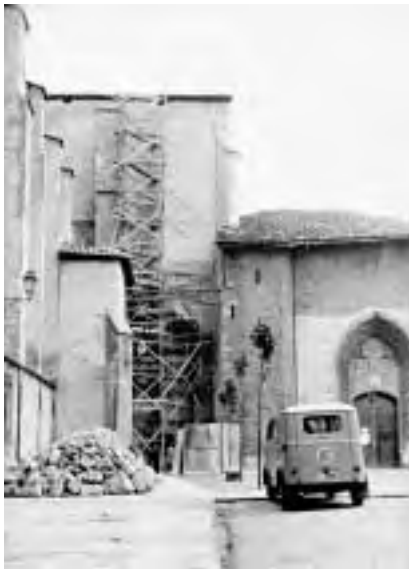
Imagen 42. Fotografía del año 1963, efectuada durante las obras de eliminación de la mitad del contrafuerte de 1856, y el descubrimiento de la portada de Santa Ana bajo la dirección del arquitecto Lorente Junquera. (Archivo Municipal de Vitoria/Gasteiz. Autor: S. Arina. Ref: LFM-397-4(3))
