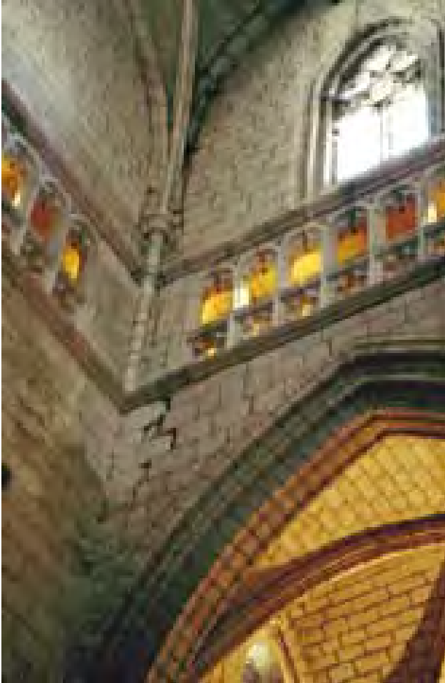
Imagen 457. Interior de la esquina noreste del transepto y de la última capilla del mismo. Se ve el sistema de grietas –el mismo mostrado en la imagen 438 desde el exterior– formado por el giro del muro hastial norte y el contrafuerte y la pilastra de esquina, que se separan completamente del muro de cierre oriental del transepto –a la derecha en la foto–. Este sistema de grietas ya se había manifestado históricamente y reparado en distintos momentos. Desde la última restauración de 1960-65 se ha vuelto a abrir, lo que se observa en la fractura de la bóveda, estucada completamente entonces
