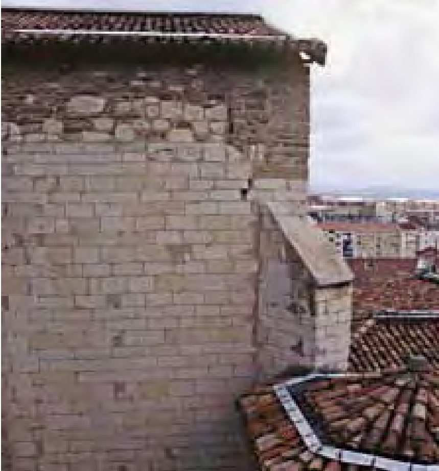
Imagen 437. Contrafuerte de la esquina suroeste del transepto, sobremontado en la torre de escaleras de la primera construcción amurallada. Se aprecia una gran fractura del contrafuerte y el muro, reparada en fecha reciente –hacia 1960–
