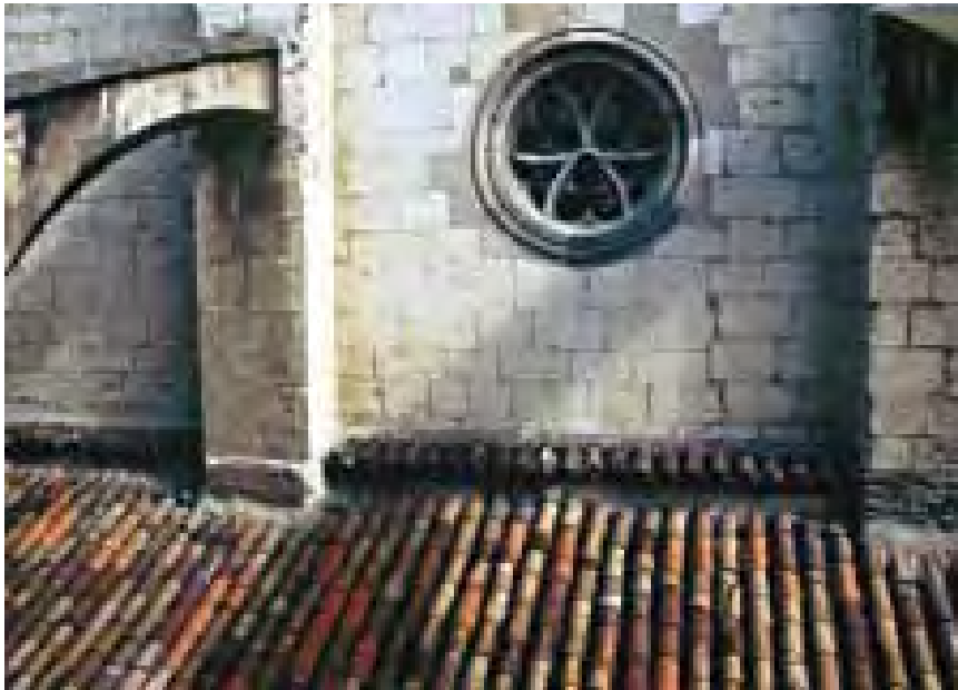
Imagen 481. Detalle de la fábrica de sillería del muro sur de la nave central. Deterioro de los materiales
