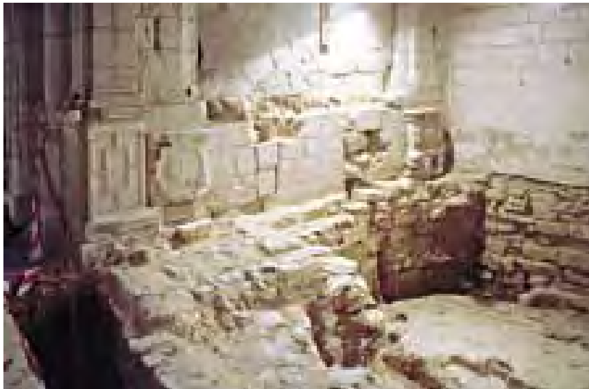
Imagen 522. Cimientos de la capilla de San Bartolomé. En primer plano el cimiento del muro de cierre sur de la nave, desmontado para abrir la capilla. Detrás, el aglomerado de cimientos distintos debidos a diferentes momentos de uso de la Catedral y la capilla
