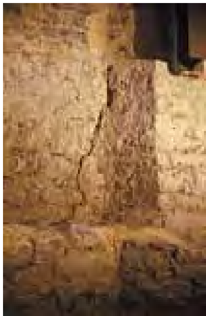
Imagen 409. Fisura descubierta al excavar las capillas de la girola. A la derecha de la foto se desarrolla la iglesia hacia el oeste. A la izquierda se encuentra el fondo del ábside dentro de la muralla del primer proyecto. La ladera descendiendo hacia este lado y la fisura denota un deslizamiento del muro de cierre en la dirección de la pendiente
