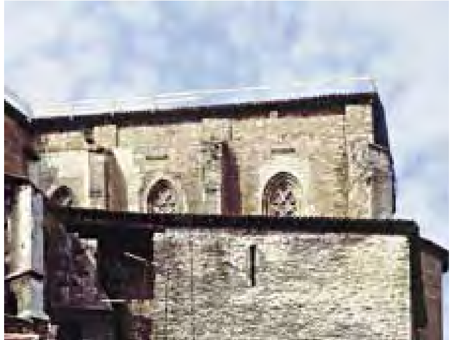
Imagen 514. Exterior del alzado este del brazo norte del transepto. Se aprecia la fisura que separa al contrafuerte noreste, a la derecha, del muro de cierre
