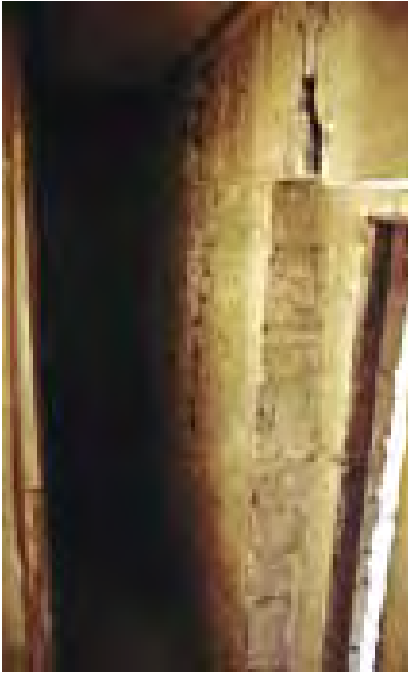
Imagen 516. Vista interior, a la altura del triforio, de las grietas que separan al contrafuerte noreste del muro de cierre oriental del transepto
