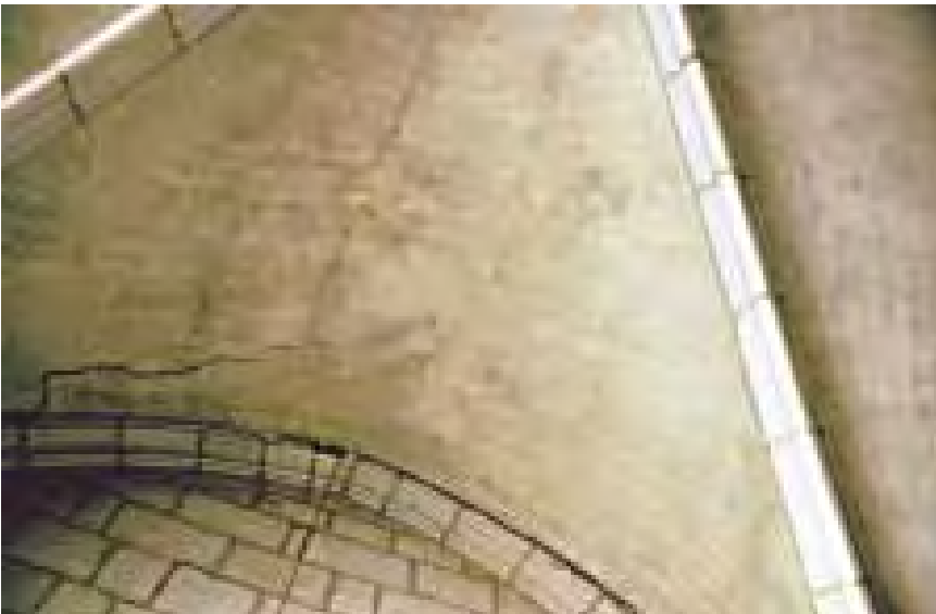
Imagen 488. Formación de grietas en los plementos sobre la portada de Santa Ana. Se aprecia la grieta transversal a la directriz de la bóveda en su clave y la perpendicular a ella, junto al arco formero
