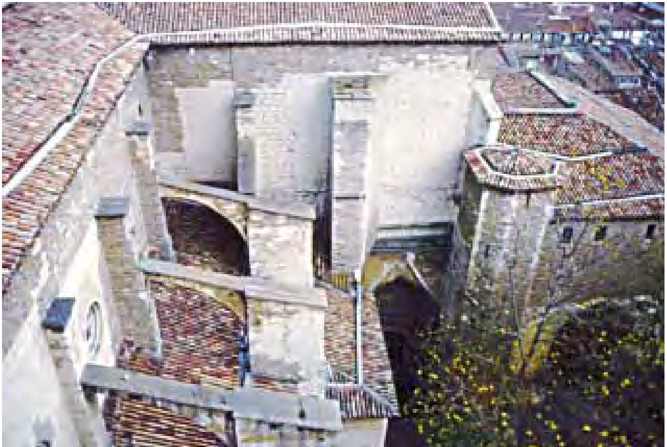
Imagen 443. Rincón suroeste de la Catedral, entre la nave central y el transepto sur –al fondo–. Se observa claramente la diferente técnica de ejecución del recrecido del muro del camaranchón de la cubierta, de mampostería sobre las fábricas inferiores, en general de sillería aunque a su vez formadas por distintas etapas. También se aprecia el sistema de contrafuertes, todos ellos distintos entre sí, y el resto del machón que reforzaba y ocultaba la portada de Santa Ana
