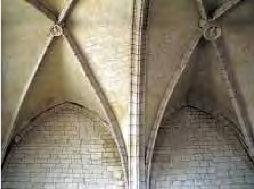
Imagen 348. Bóvedas del primer y segundo tramo del transepto sur, hacia oeste. Se aprecian las grietas que separan los plementos y arcos formeros del muro
