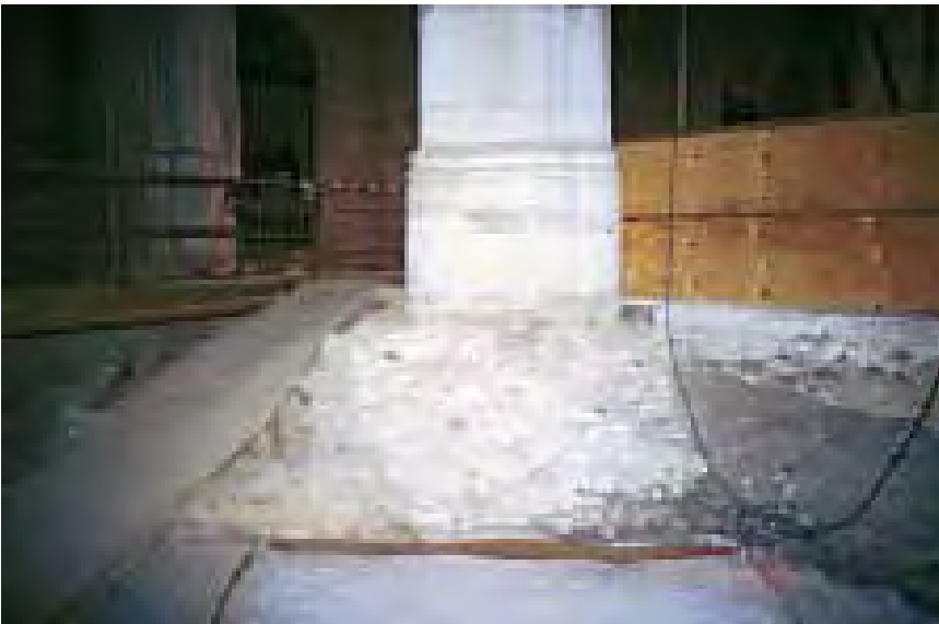
Imagen 520. Cimiento del segundo pilar norte de la nave central, ejecutado con fábrica masiva, sin aparejar y sin forma, en una estructura altamente compresible y degradable. Se aprecia también su mal apoyo sobre los restos de estructuras anteriores
