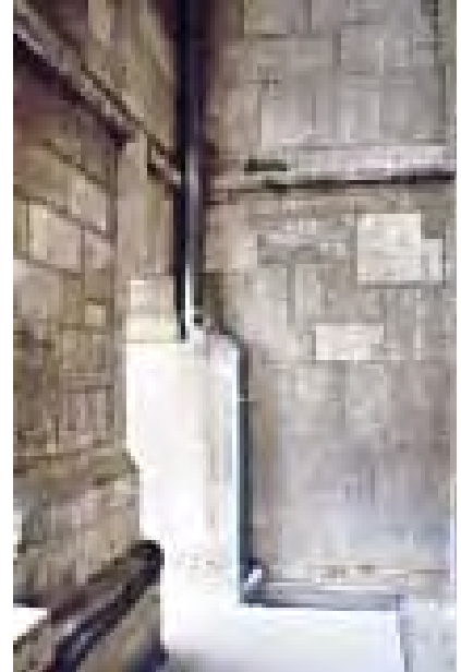
Imagen 596. Detalle de registro de una bajante en su encuentro con el pasillo de ronda
