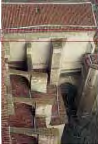
Imagen 39. Vista exterior (desde el oeste) del crucero meridional. En la parte alta del muro, se aprecia claramente el recrecido realizado en mampostería para soportar las cubiertas de madera y así aligerar el peso sobre las bóvedas
