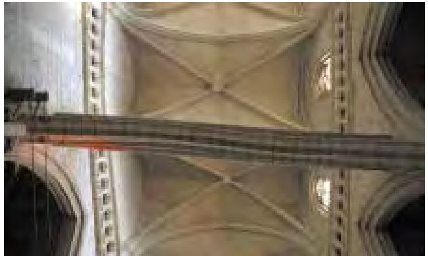
Imagen 351. Bóvedas del transepto sur. Vista cenital del segundo y tercer tramos, donde se aprecian las grietas junto a los muros y en el intradós de los plementos. En primer plano, uno de los arcos codales
