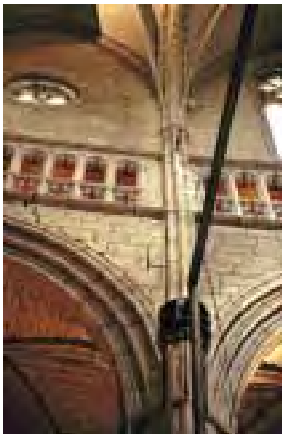
Imagen 499. Zona del tas de charge del cuarto pilar norte de la nave, con las grietas que lo desgajan de las enjutas de los arcos diafragma por causa del empuje del arco perpiaño de la nave lateral, detrás en la foto
