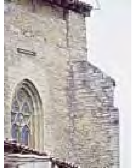
Imagen 436. Contrafuerte de la esquina noreste del transepto. Se aprecia la grieta entre el muro y el contrafuerte debida al giro de éste acompañando a todo el cuerpo de la capilla nororiental en que apoya
