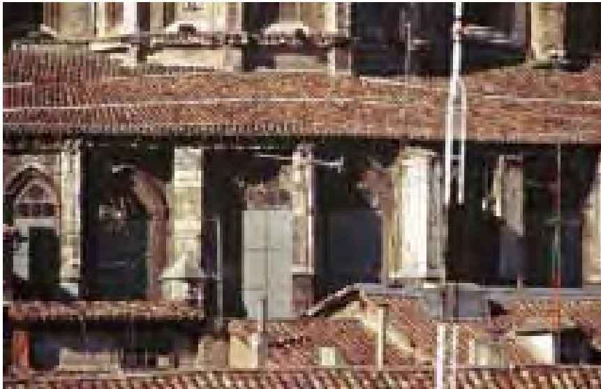
Imagen 415. La girola desde el este. Se ven los botareles mochos correspondientes a la primera etapa gótica y, entre ellos, los ventanales de tracería de las capillas absidales
