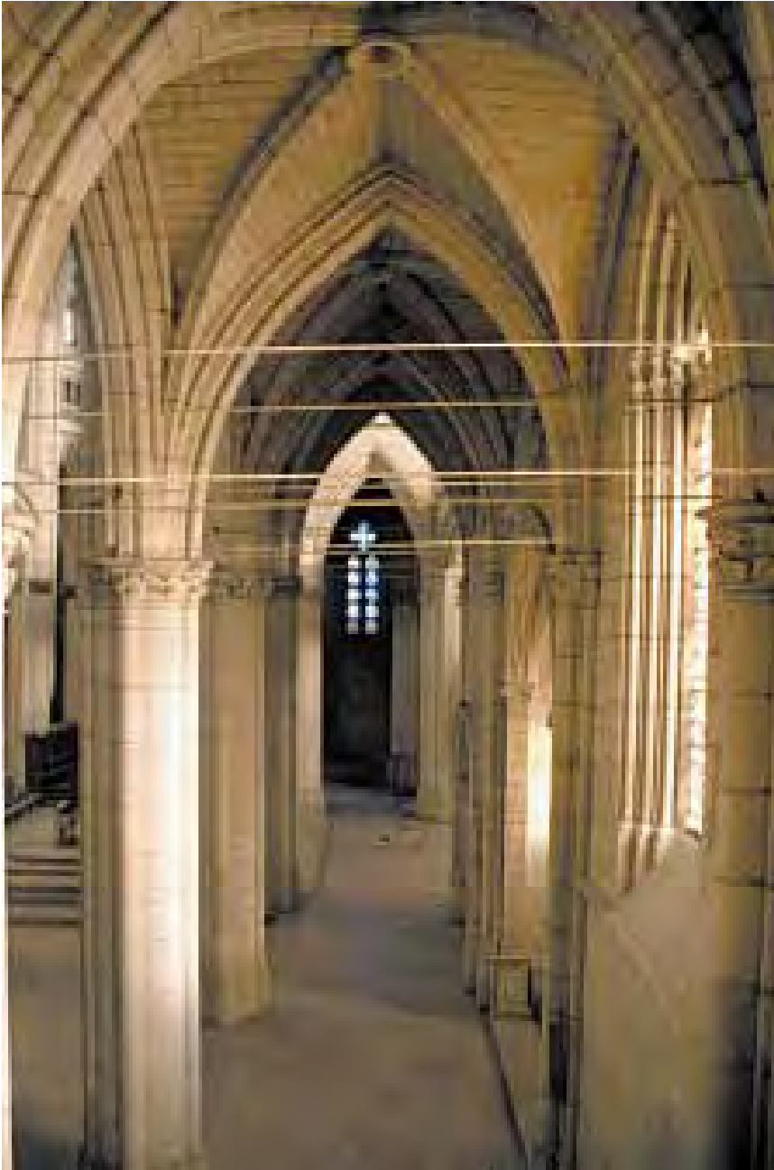
Imagen 422. Sucesión de arcos perpiños de la nave sur. En los semiarcos izquierdos que descansan en los pilares de la nave central se aprecia la pérdida de curvatura debida a la sobrecarga de sus riñones por los contrafuertes del muro de cierre superior
