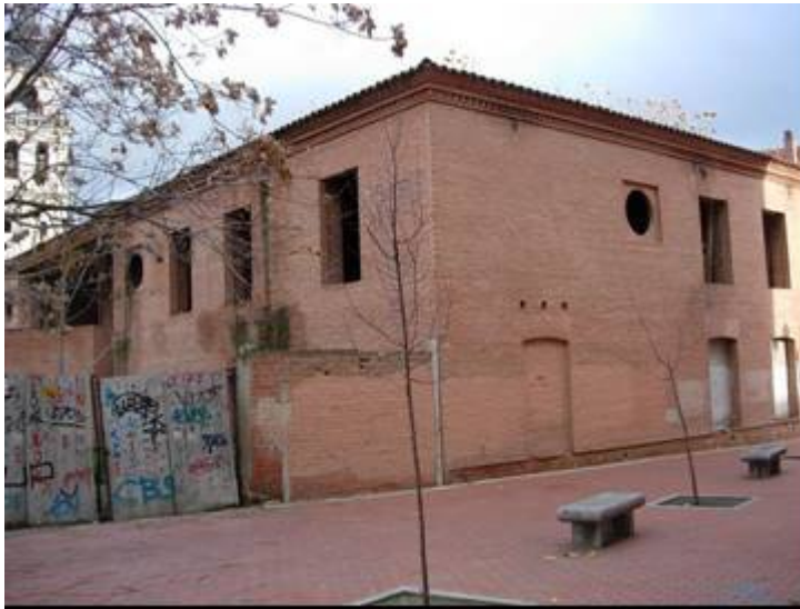
Fig. 129: Estado de la paralización de las obras de la casa de los Lizama (Colegio Menor de Santa Justa y Santa Rufina)
