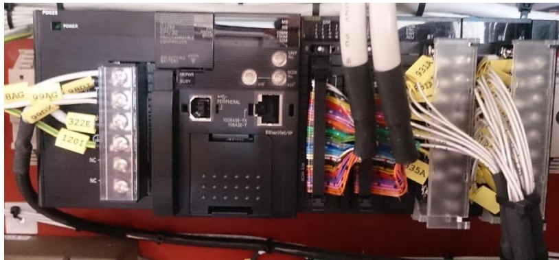
Figura 41. Distribución final del PLC.
