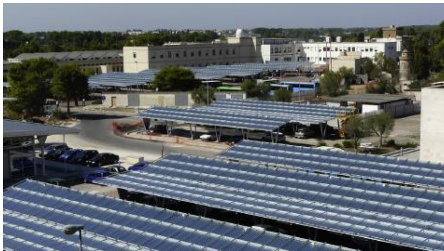
Figura 27. Sistema fotovoltaico de la universidad de Salento (Fuente: [30])
