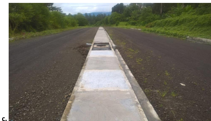
Fig. 28. a. Imagen de una carretera convencional a 500 m del tramo final de la Autovía Malabo-Luba. b. Imagen de una balsa de agua en plena carretera, a consecuencia de la escorrentía de lluvia en tramo final de la Autovía. c. algunas estructuras de la autovía (Fotos: S. Nsue Esono).
