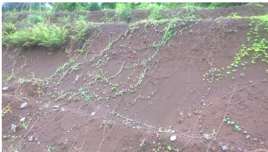
Fig. 13. Imagen de un desmorte en la Autovía Nacional Malabo-Luba, en la que se observa derrumbamiento y acumulación de sedimentos en la base de la misma (Fotografía de S. Nsue Esono).
