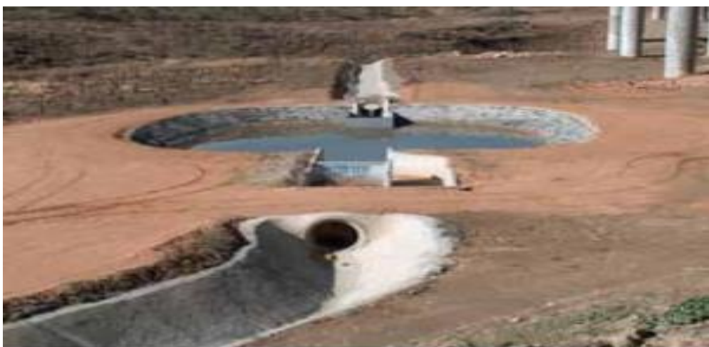
Fig. 23. Balsa de decantación de sedimentos y de contención de vertidos accidentales, conectados al sistema de drenaje en la autopista Radia 4 (Madrid). (Fuente: Martín Duque et al., 2011).
