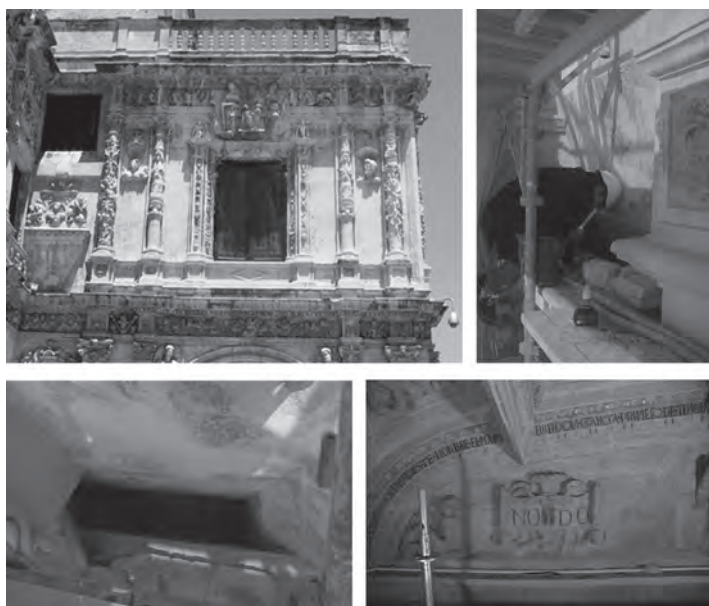
Figura 09. a) Fachada principal del siglo XVI, en la primera planta se manifiesta enmarque piramidal de tragaluz, en la actualidad cegado, en dirección sur. b) Observando el interior del tragaluz cegado. c) Interior del tragaluz abierto durante las obras. d) Interior de la Sala Capitular Baja, muro sur, sillares decorados con cartela y texto NO8DO, que ciegan el tragaluz del siglo XVI. Fotografías de autor.
