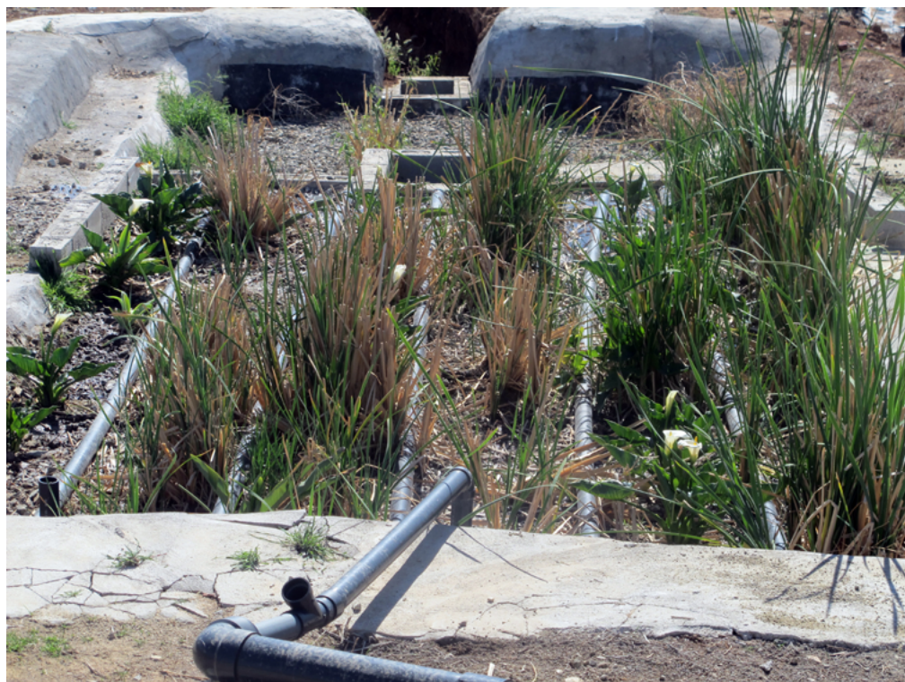
Fig. 4: Fotografía del sistema de humedales construido.
