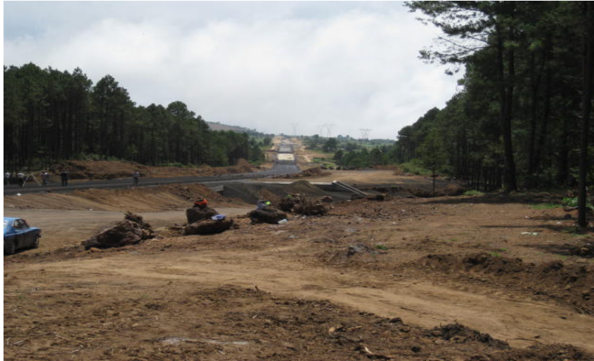
Ilustración 5.7.-Panorámica de la etapa constructiva de la carretera a su paso por el ANP "San Juan del Monte". En la porción central inferior se observa la construcción de paso inferior vehicular que funcionará como paso de fauna.
