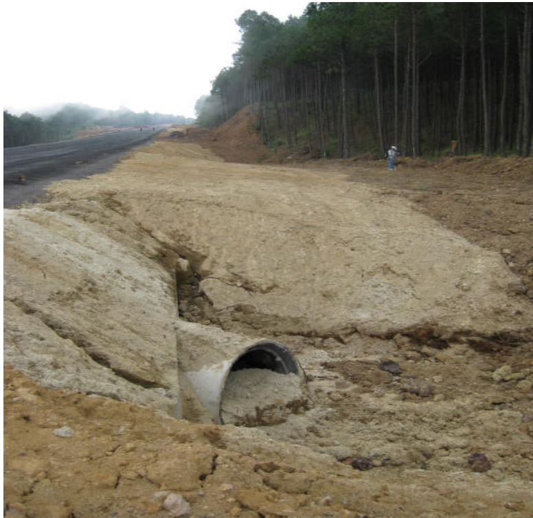
Ilustración 5.8.- Obra hidráulica de la carretera que se adaptará como paso de fauna en el trayecto que discurre por el ANP "San Juan del Monte"
