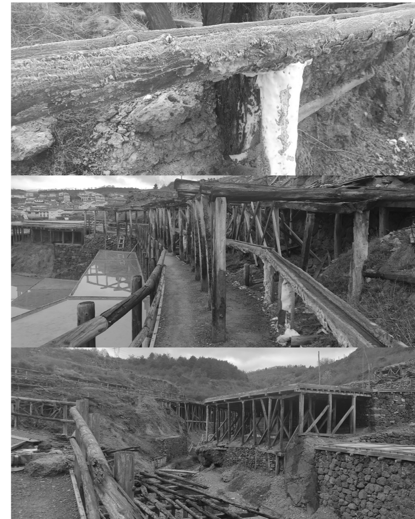
Imágenes de los sistemas constructivos usados en las Salinas de Añana Fuente propia
