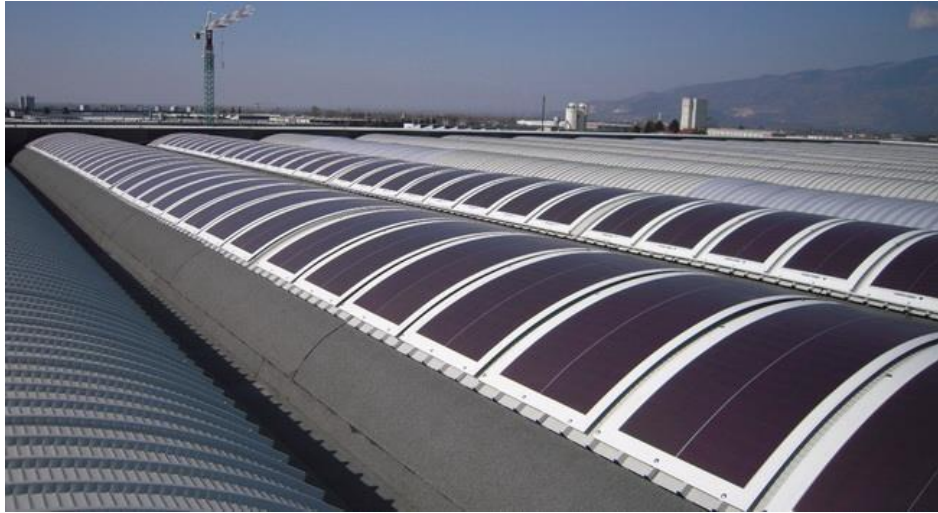
Figura 25. Paneles solares flexibles basados en a-Si:H
