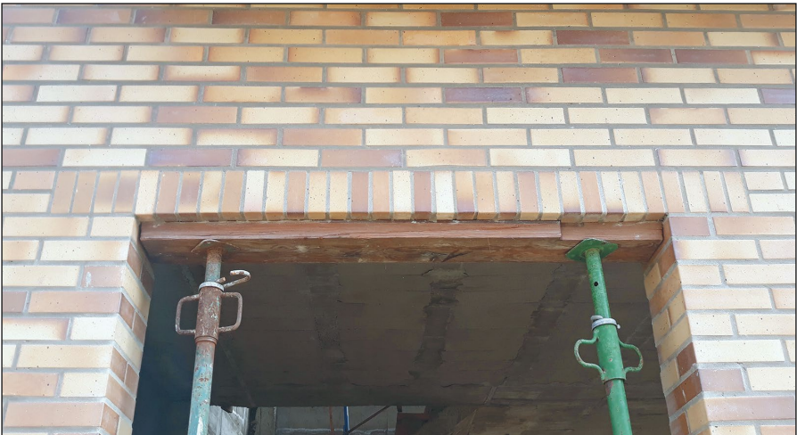
-Imagen H- Realización de un dintel armado de fábrica mediante un aparejo dispuesto a sardinel.
