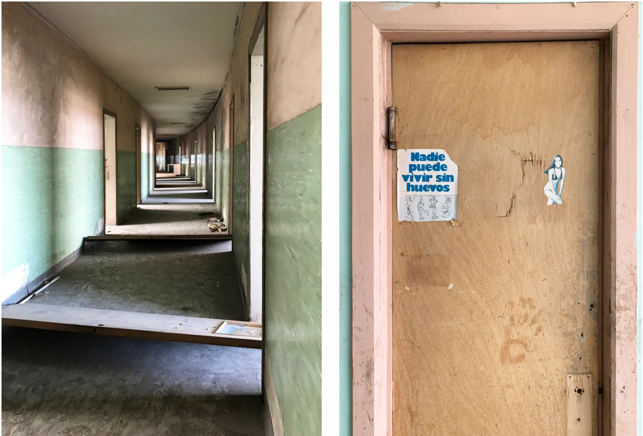
Imagen 92: Corredor interior de la Residencia Estudiantil de la UCE en estado de abandono. Fotos: C. Luna, 2019. Edición: N.LL.
