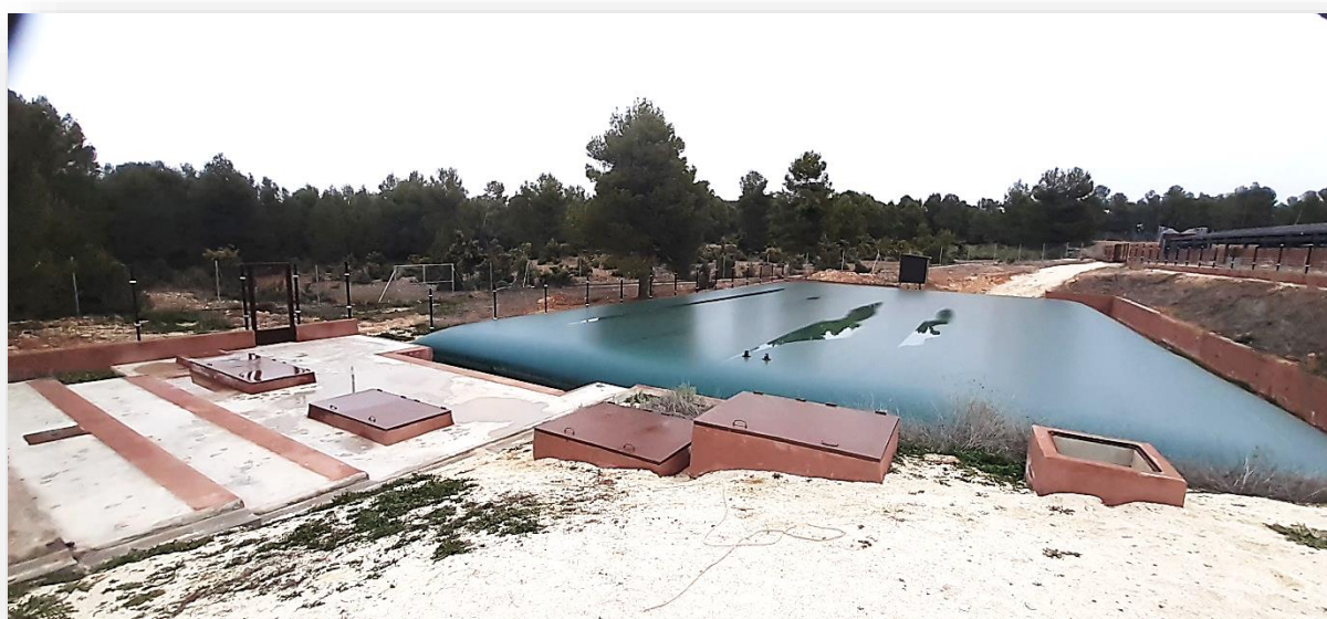
Fotografía 1. Sistema de tratamiento actual por aireación prolongada
