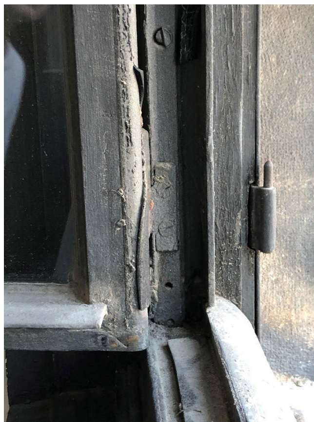
Figura 8. Foto del informe mostrando el deterioro de las juntas y del material.
