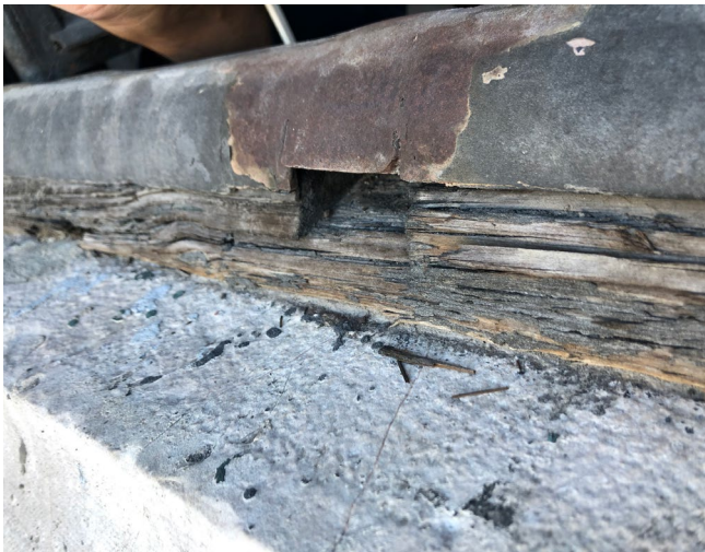
Figura 9. Foto del informe. Estado de deterioro del soporte de madera una ventana.
