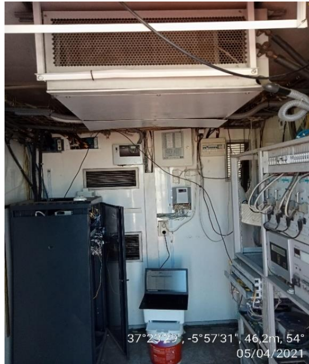
Figura 7. Interior estación base 4G, imagen cedida por ELECNOR SA.
