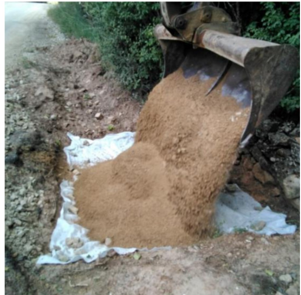
Fig. 8.- En la imagen proceso de cubrición por sellado, mediante geotextil, gravas y arenas.
