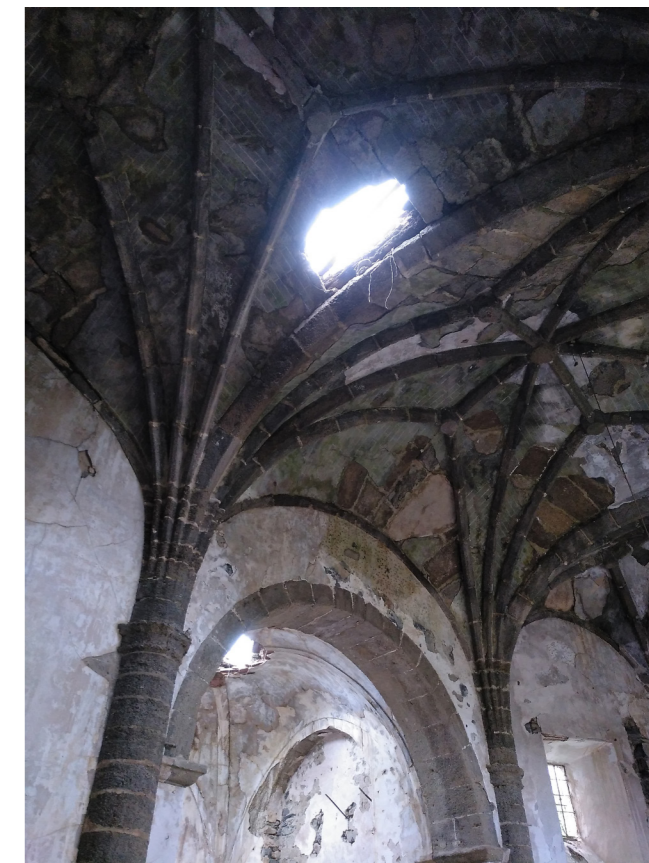
Fig. 59. Agujero en el techo de la iglesia. Fotografía del autor.
