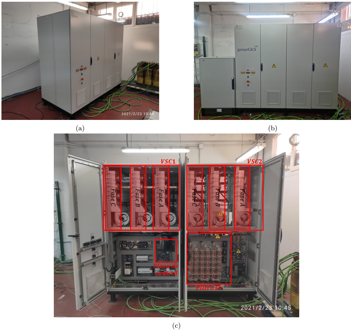
Figura 5.9: Convertidor electrónico de potencia sobre el que se ha implementado el sistema de control y comunicaciones: (a) Vista lateral, (b) vista frontal y (c) equipo con las puertas abiertas
