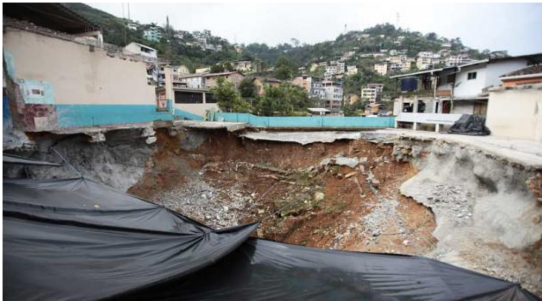
Figura 5 Socavón registrado en Zaruma 2017
