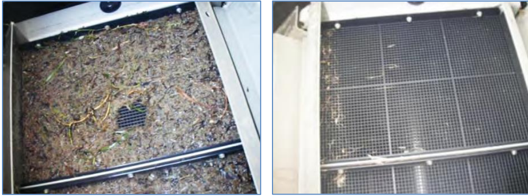
Figura 17. Algas y otros tipos de materia marina bloqueando la pantalla del sistema de captación (izquierda) y la misma pantalla después de realizar una limpieza (derecha) en una planta desaladora del Océano Índico.
