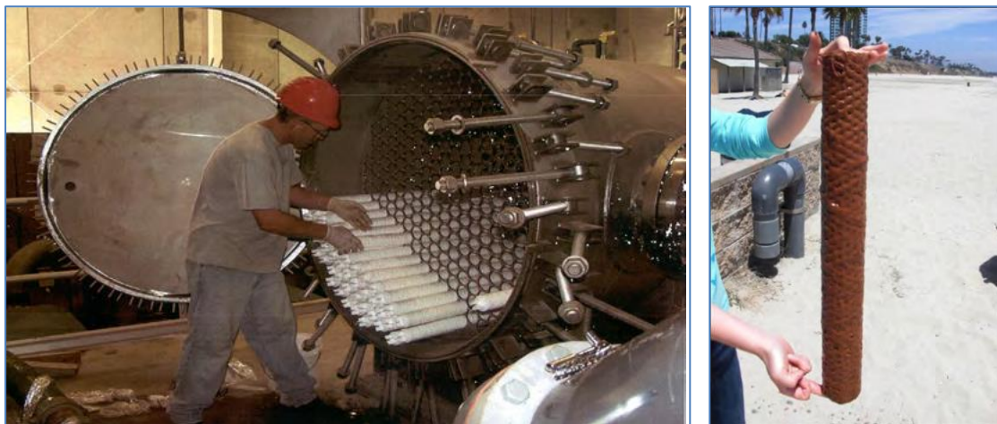
Figura 27. Cartuchos instalados en un filtro horizontal (izquierda); ensuciamiento de un cartucho durante un evento severo de marea roja (derecha). Fuente: Anderson et al. , 2017.
