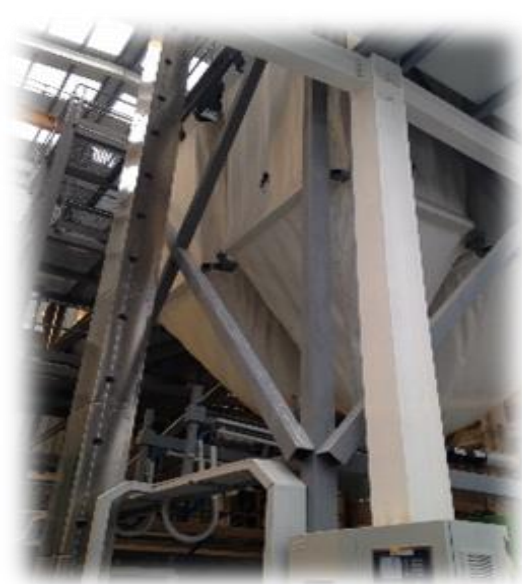
Figura 17: silos de almacenamiento. Fuente: elaboración propia.
