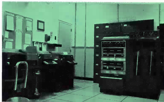
Figure 6. Sistema de Telecomunicacion
