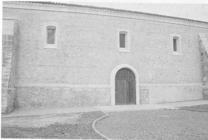
Detalles de la cantería caliza de Campaspero y de la carpintería de madera de haya y latón de las puertas y ventanas de la fachada sur. Foto: LyC.
