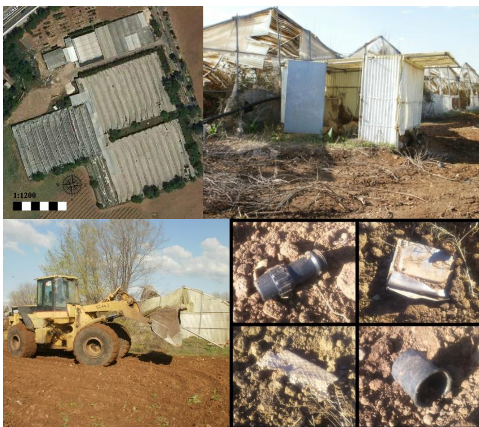
Figura 5. Invernadero de rosas en el 2009 (fuente: Nomecalles, ICM) y desmantelamiento de la instalación
