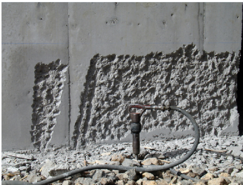
figura 4_ Proceso de picado con martillo neumático en muro de hormigón. Interior de la Iglesia del Santísimo Redentor en La Laguna, Tenerife. MENIS Arquitectos
