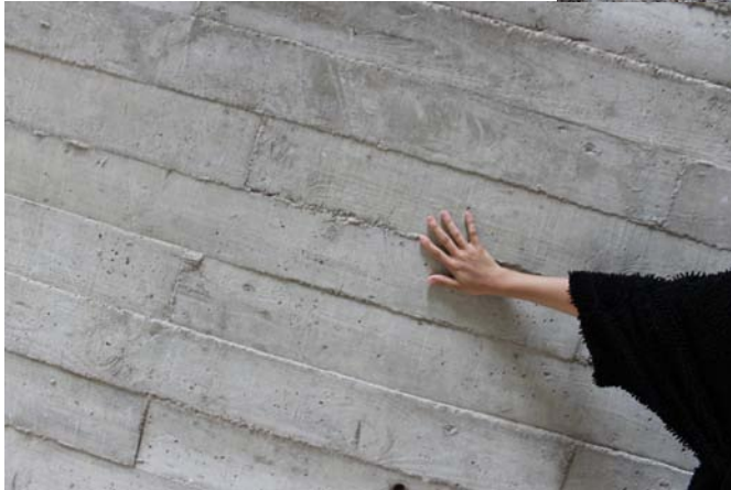
figura17_Las distintas texturas del hormigón que se encuentran en el edificio: roto, picado y encofrado.
